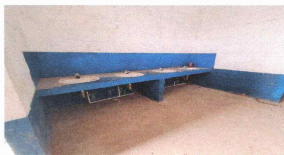
Foto 2: los lavamanos con su su respectiva agua y drenaje de la misma.
