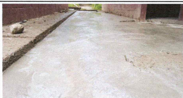
Foto 9. losa de patio en el camino al comedor.
